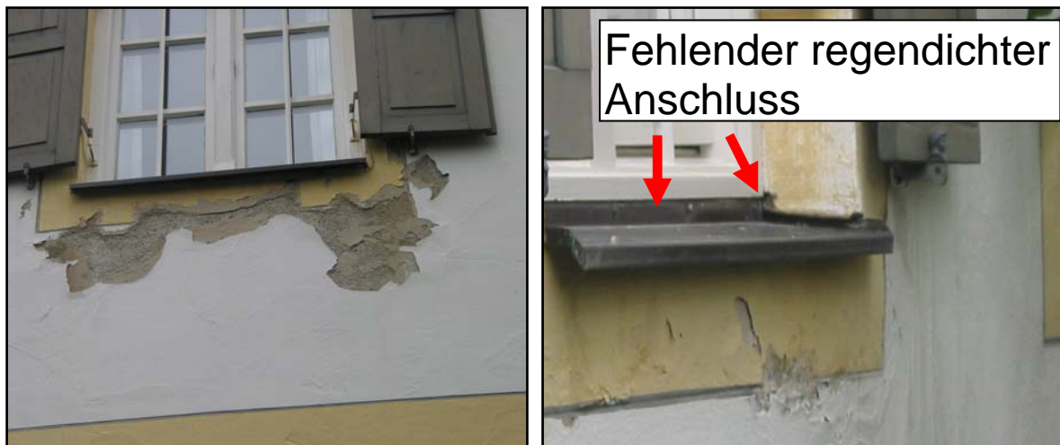
Abbildung 8: Ansicht Fassade mit erheblichen Feuchteschäden unterhalb der Fensterbank aufgrund der Hinterläufigkeit des Fensterbleches.
