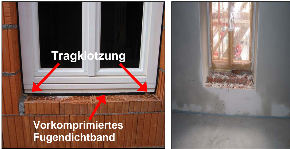
Abbildung 12: Mangelhaft vorbereitete Brüstungsflächen.
