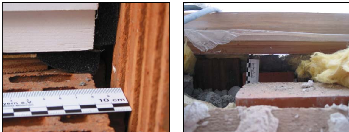
Abbildung 13: Mangelhaft vorbereitete Brüstungsflächen.
